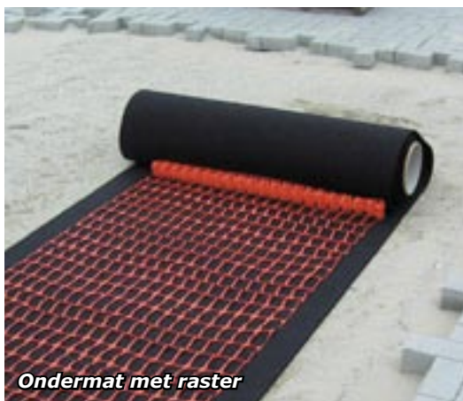
De uitgerolde ondermat met raster en rechts de vast gelijmde optische detectie kabel
